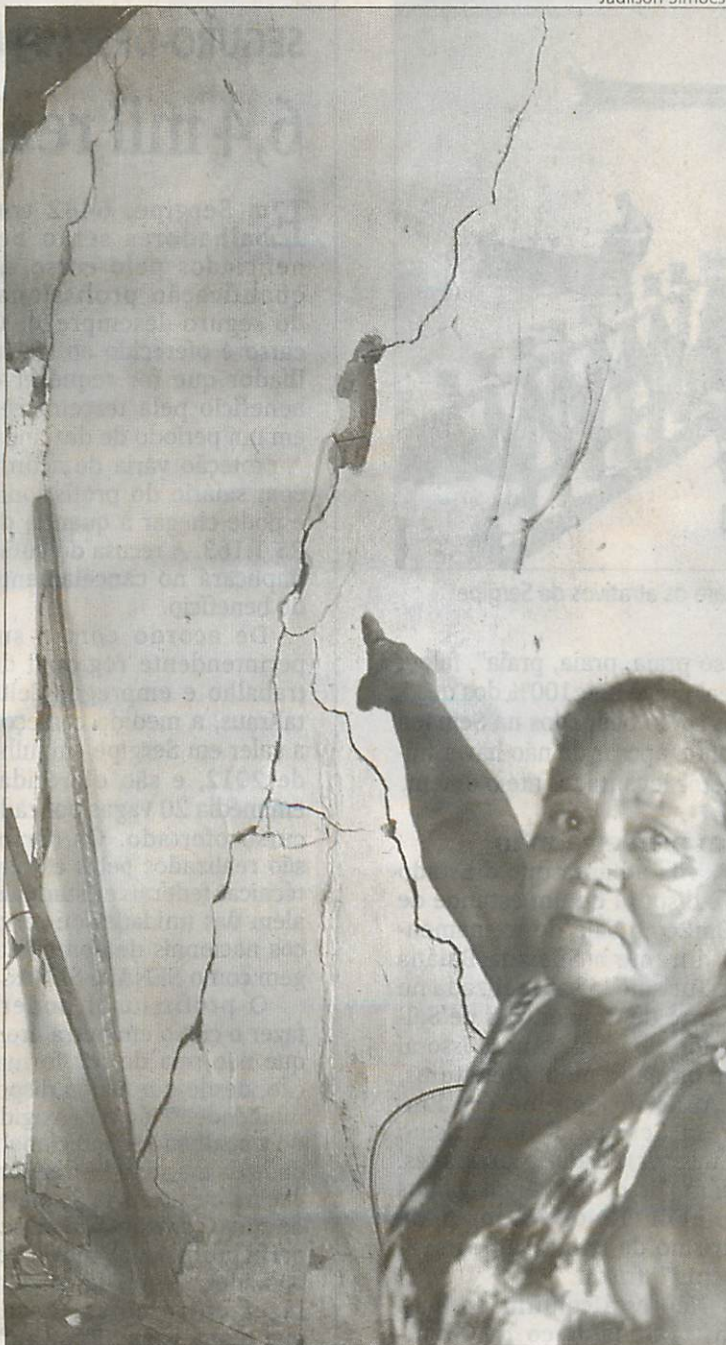
MORADORA do povoado Tabocas, em Socorro, mostra rachaduras
