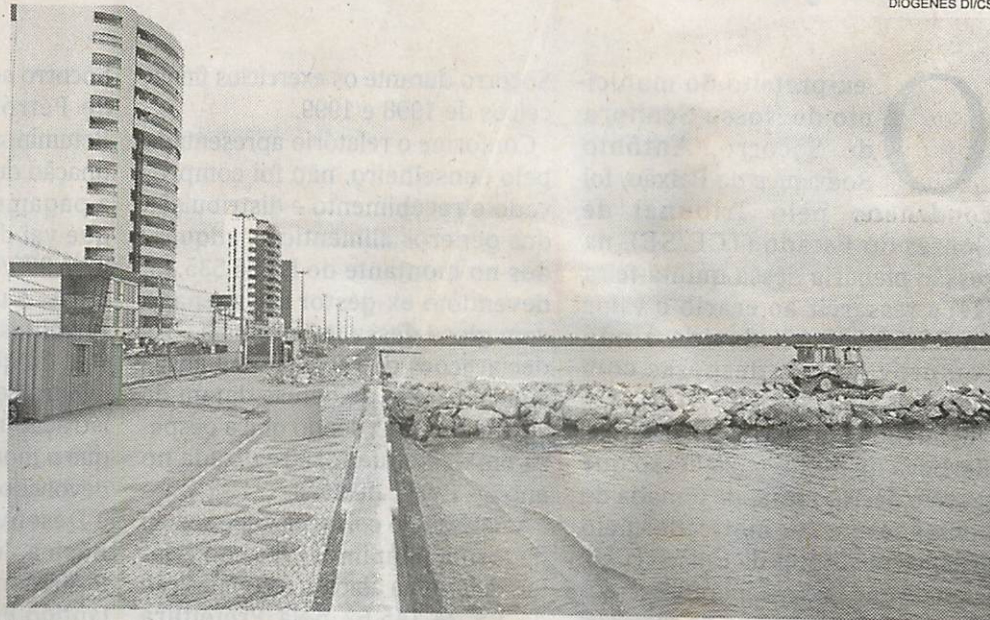
■ Ministério Público diz que as obras devem ser suspensas enquanto não for obtida a licença ambiental
