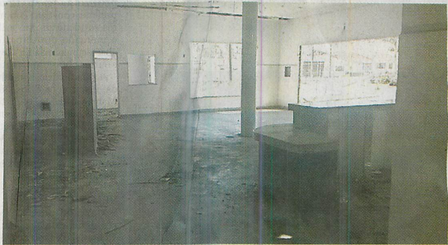
Mas obra foi abandonada pela atual gestão
